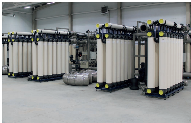
С нуля возведена новая насосно-фильтровальная станция, которая в скором времени с запасом обеспечит первоуральцев чистой водой.
